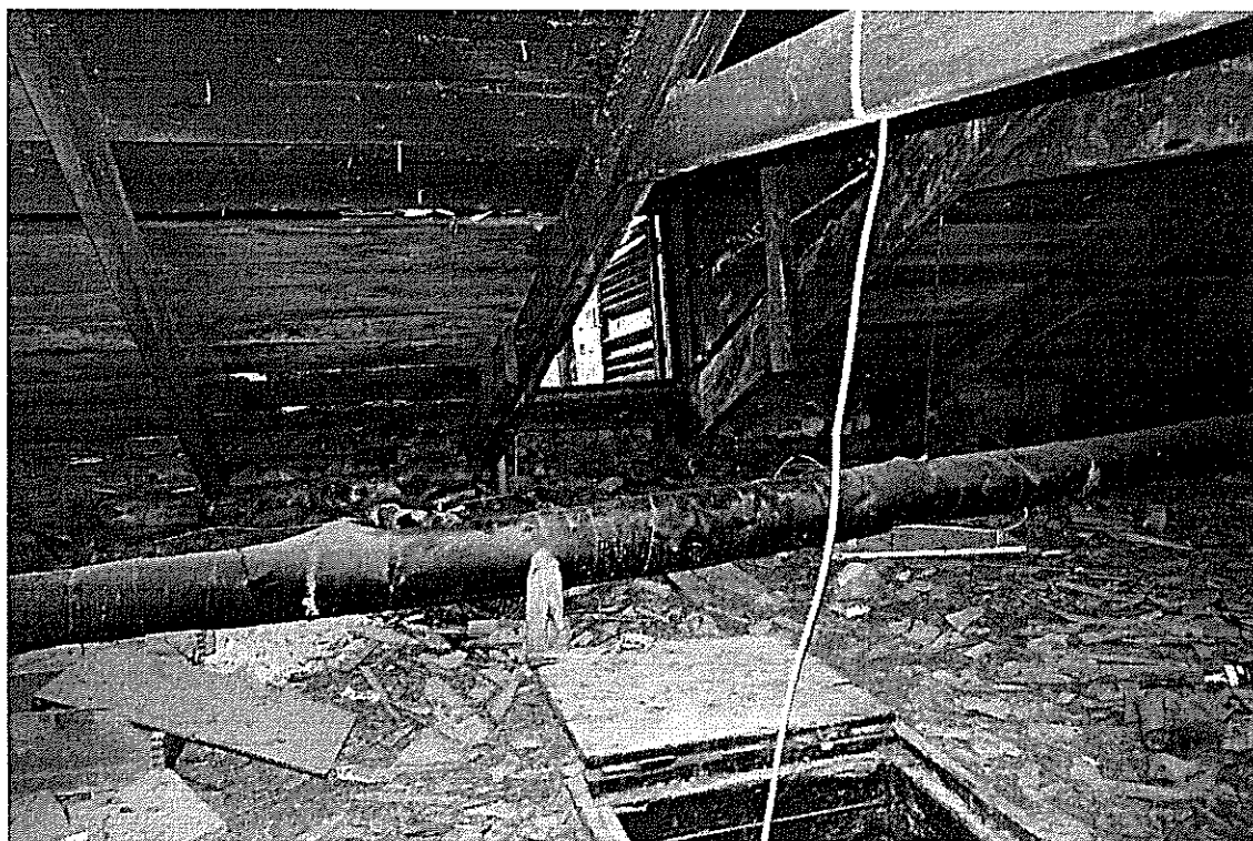
Рис. 9 Конструкции крыши. Поражения гнилью стропильных ног и обрешетки, следы протечек.
